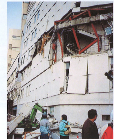
阪神・淡路大震災で脱落した外壁
